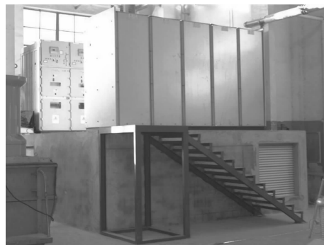
图 10 配网设备平台实物图
