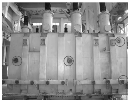
图 4 变压器 UHF 检测传感器安装位置
